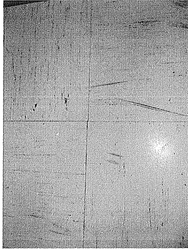
DALLES DE SOL THERMOPLASTIQUES 4 GRISES CONTENANT DE L'AMIANTE APRES ANALYSE. ECHANTILLON N°10793. CF CROQUIS POUR LA LOCALISATION.
