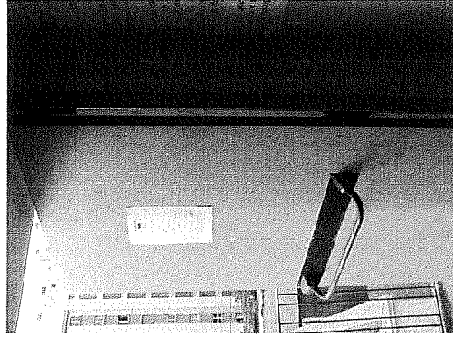
PORTE COUPE FEU SUSCEPTIBLE DE CONTENIR DE L'AMIANTE. UNE VERIFICATION SERA NECESSAIRE EN CAS DE TRAVAUX SUR LE MATERIAU. CF CROQUIS POUR LA LOCALISATION.
