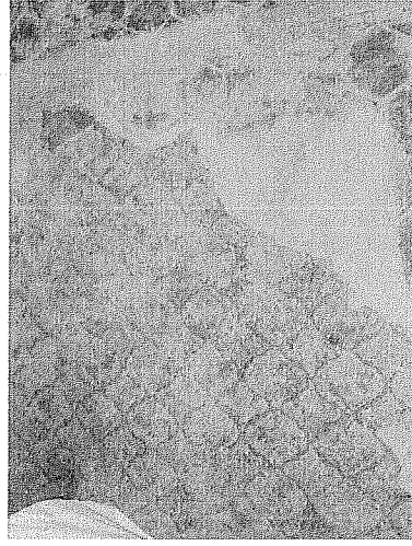
RENETEMENT DE SOL DE TYPE LNOLEUM CONTENANT DE L'AMIANTE. CF CROQUIS POUR LA LOCALISATION.
